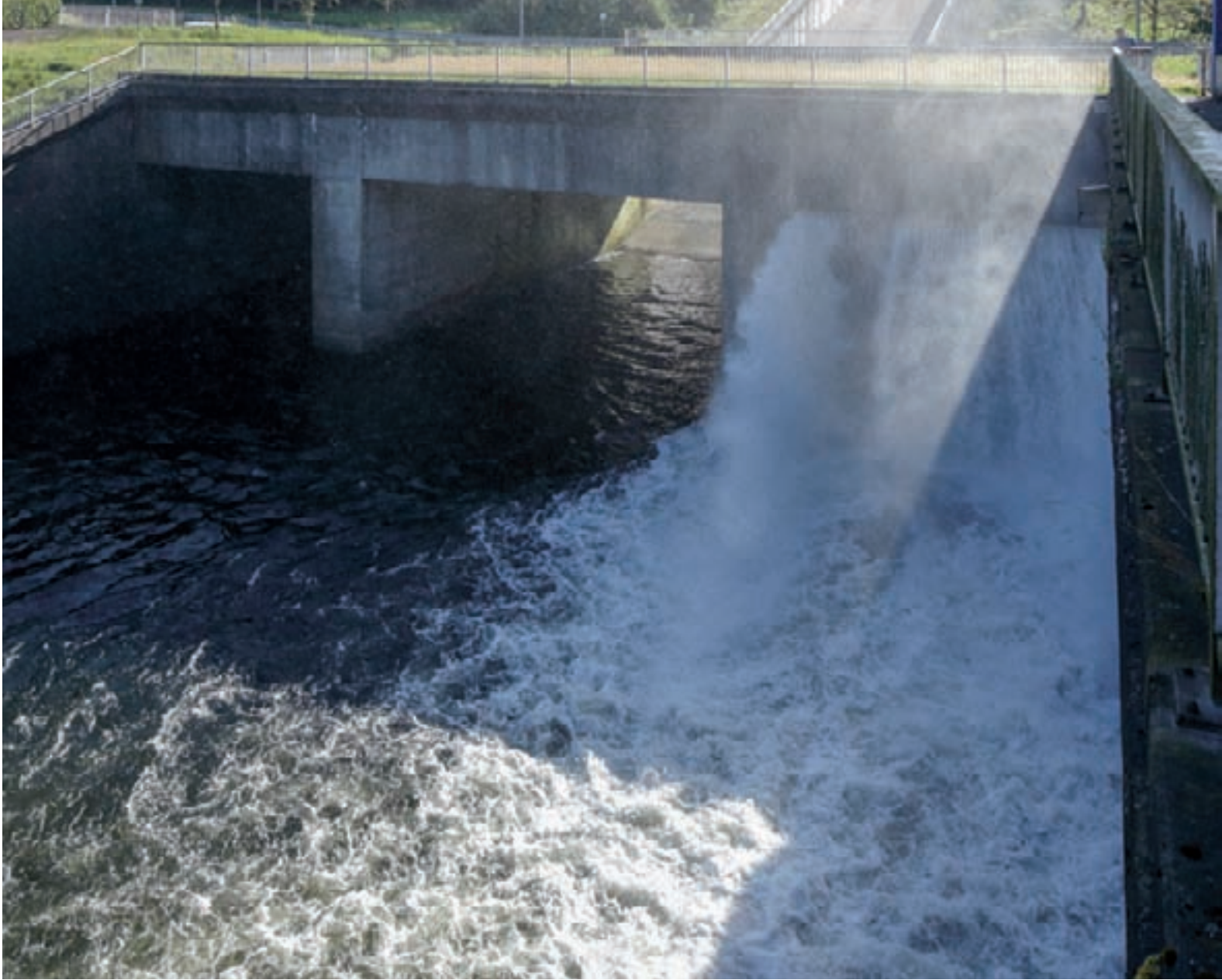
Über das Auslaufbauwerk wird das Abfließen des Ausgleichswassers geregelt
